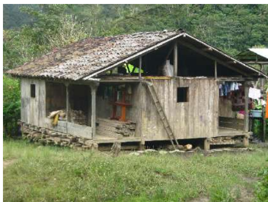
Foto 45: Foto Vivienda en estado regular (Barrio Loyola)
