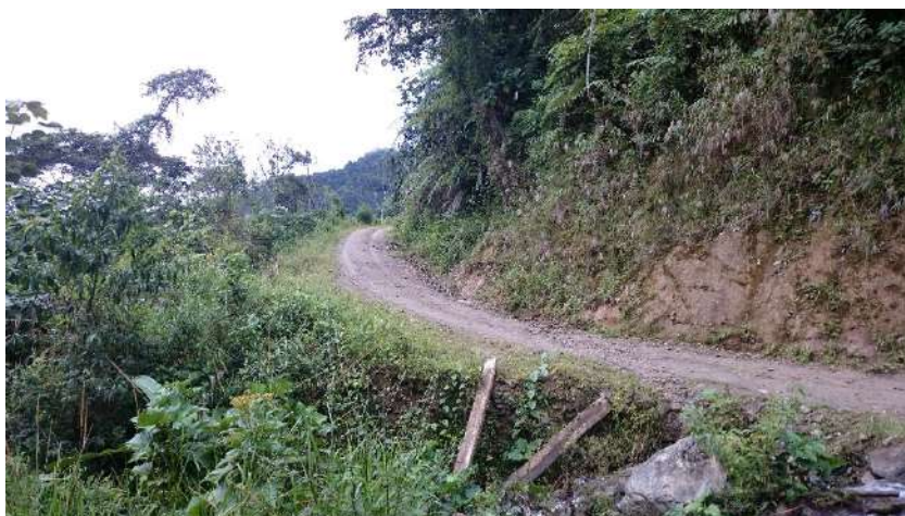
Foto 64: Foto. Viales con laderas y sin muros de contención aumentando la peligrosidad de la vía.
