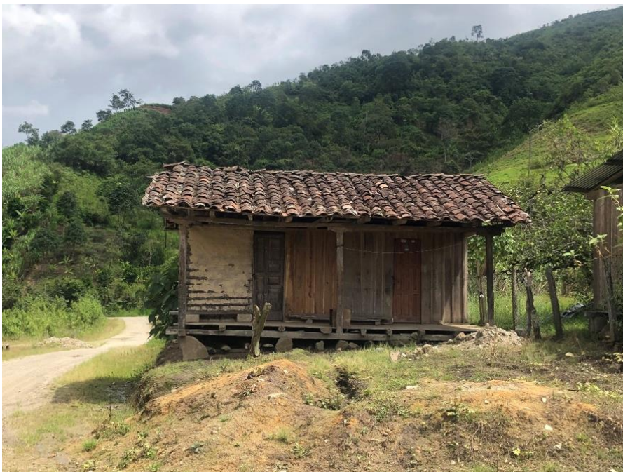
Foto 28: Vivienda en estado malo
